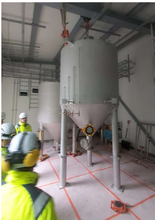
Kuva 3. Kaasunkäsittelyrakennuksen aktiivihilisuodattimet (Kuva: Veli-Matti Hatvala)
