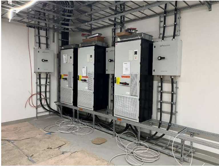
Kuva 7. Tulopumppujen taajuusmuuttajia asennettuna paikalleen. (Kuva: Petri Ylönen).
