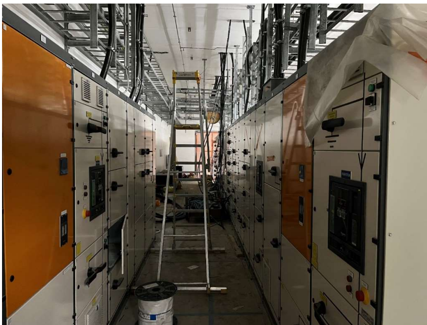
Kuva 6. Keskuksien kaapelointi meneillään (Kuva: Petri Ylönen)
